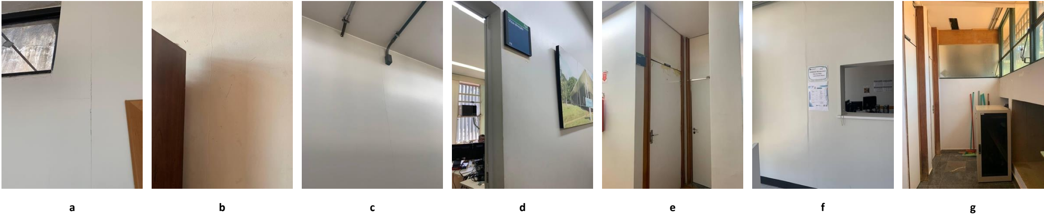
Fig. 1 – Aspectos do estado de conservação das paredes internas, com repintura recente.
