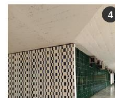
Laje inclinada na varanda
