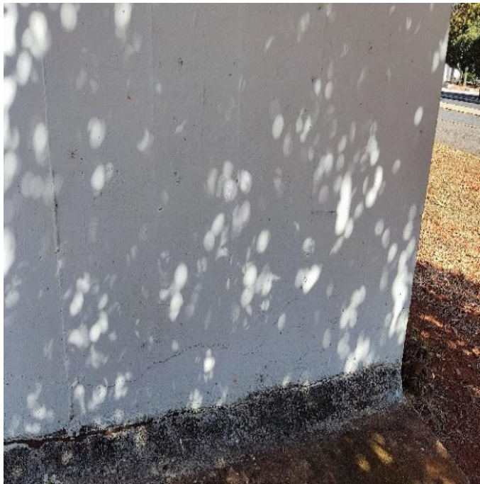
Fig. 4 – Depósito de sujidade e presença bolor no rodapé de arremate entre a calçada e a parede da fachada oeste.
