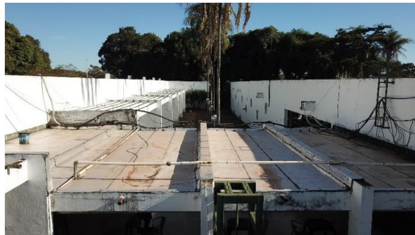
Fig. 2 - Cobertura da FE-5: tubulações, fiações e cabamentos sobre a cobertura.
