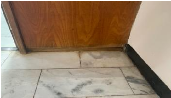
Fig. 2 – Desgaste na borda inferior do painel de madeira causada pela água de limpeza.
