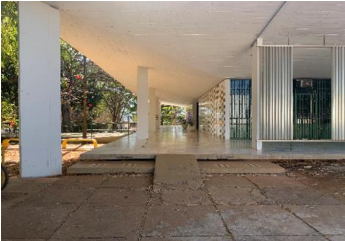
Fig.2 – Calçada de acesso à circulação leste, com rampa e degraus danificados.
