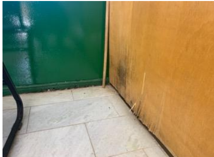
Fig. 4 - Painéis de madeira com presença de mofo causada pelas infiltrações.
