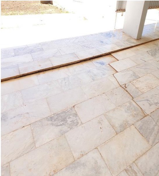
Fig.5 – Fissura no sistema de piso, localizada na interface entre a laje da borda e o lastro sobre aterro - início do deslocamento do mármore.
