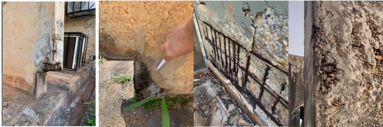
Figura 72 - Manifestações patológicas observadas nos pilares do ICC Norte. Fonte: Alves (2022).
