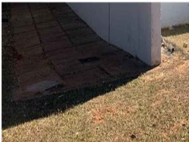
Fig.4 - Placas da calçada trincadas e desniveladas.
