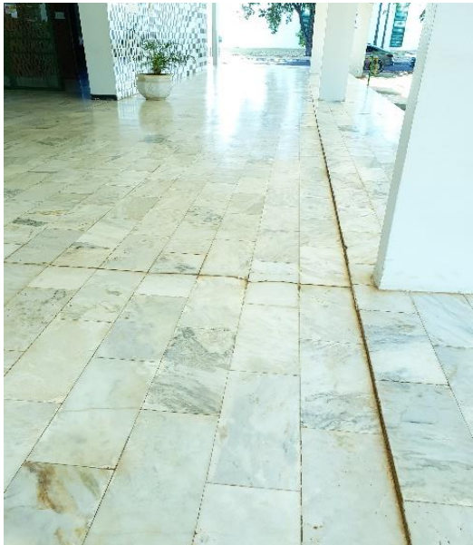
Fig.4 – Fissura no sistema de piso, localizada na interface entre a laje da borda e o lastro sobre aterro.
